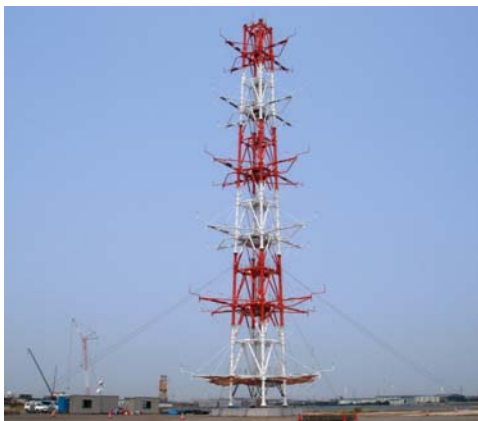
図 2.11 洋上風況観測タワー上部
