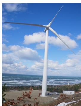
岩城勝手風力発電所
