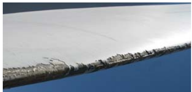
写真6 風車ブレードのエロージョンの様子
