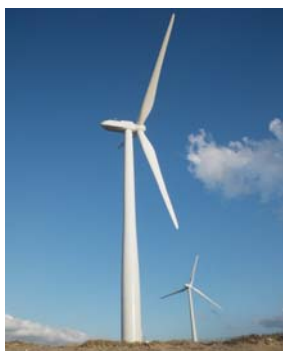
雄物川風力発電所
