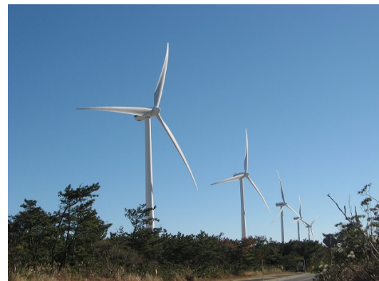
神栖風力発電所
