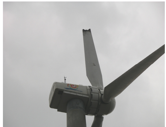
落雷によるブレードの被害事例
