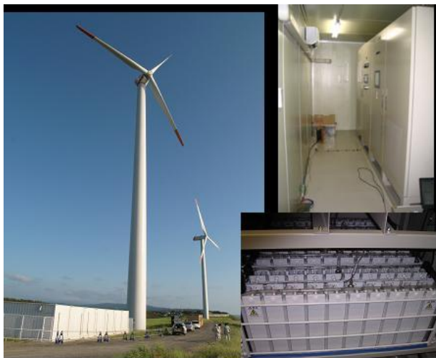
図5 風力発電出力平滑化 実証試験設備 (西目風力発電所)
